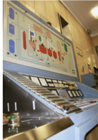
Die Technik stammt aus den siebziger Jahren.
