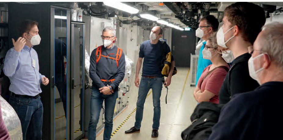
Nicht nur die Großgeräte, sondern auch die Gebäudetechnik, die notwendig ist, um hier arbeiten zu können, beeindruckt: Dr. Tobias Froböse, Technischer Leiter, erklärt das Innenleben des HITec. Foto: Friederike Günzel
